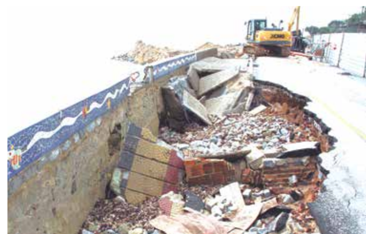
Processo de erosão destruiu grandes trechos da calçada e da via
