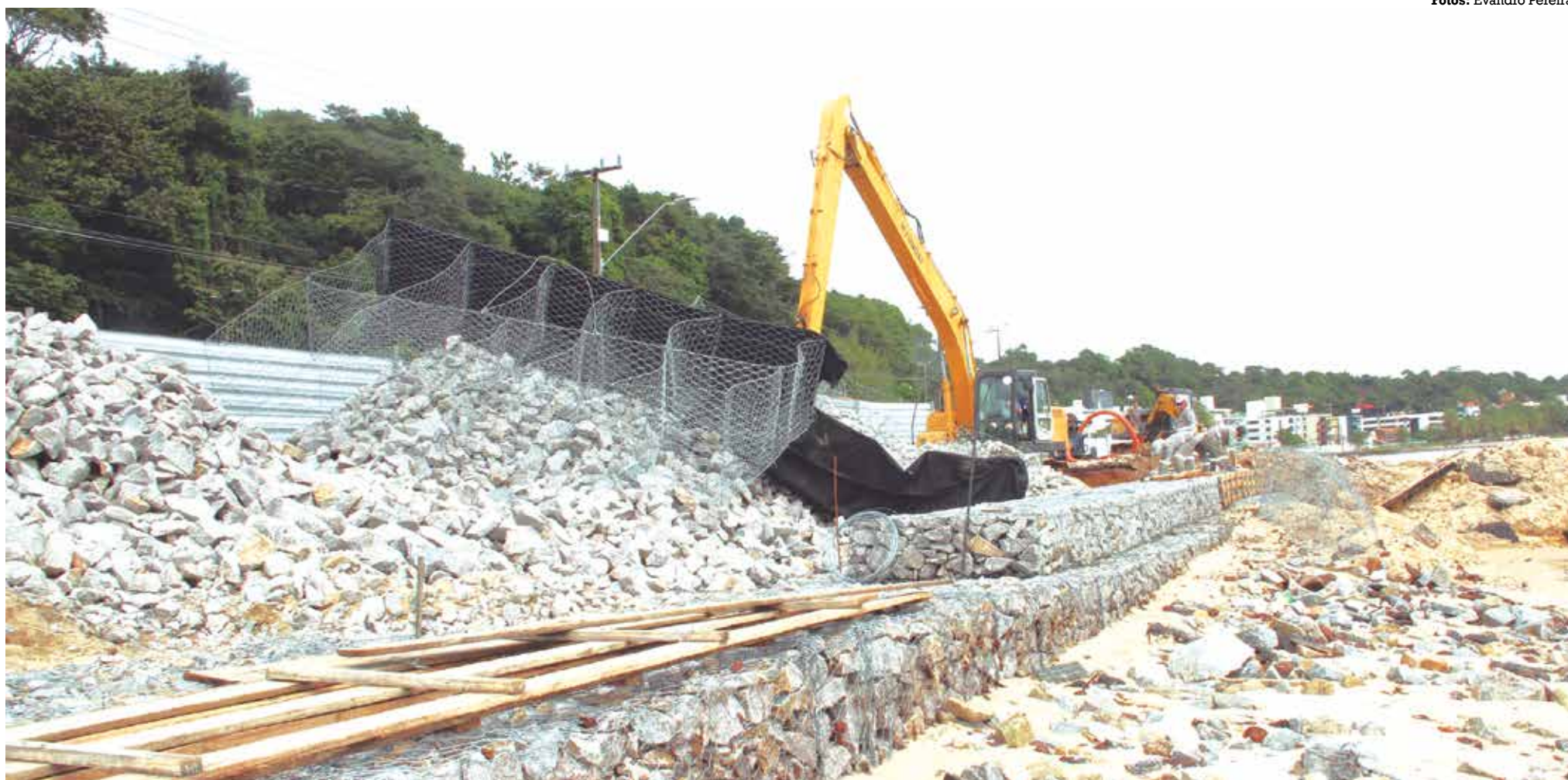
Primeira etapa do projeto de recuperação da calçadinha da Praia do Cabo Branco, destruída pela força das marés altas, é a construção do muro de gabião visando conter a erosão
